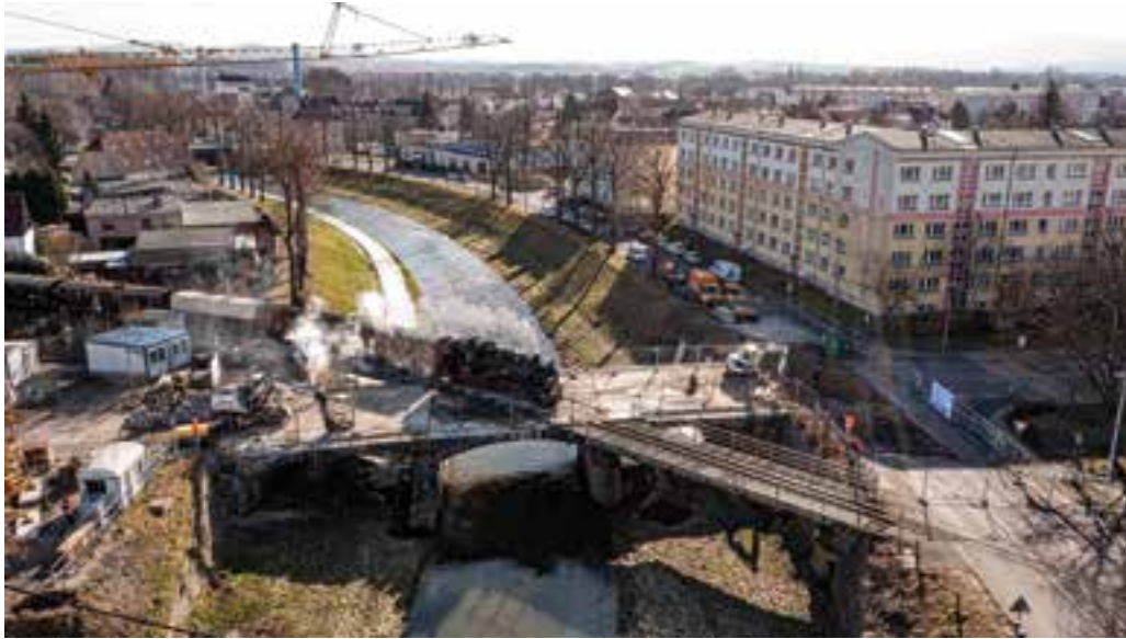
10 Letzte Zugquerung am 27. Februar 2021 vor dem Brückenabbruch © Landesamt für Straßenbau und Verkehr Sachsen
