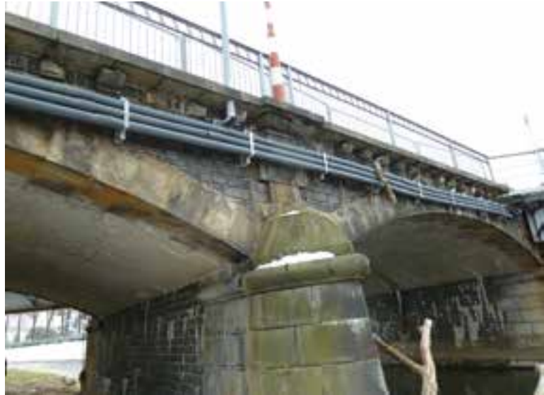
3 Flussquerung mit Pfeiler vor der Instandsetzung © VIC Planen und Beraten GmbH
